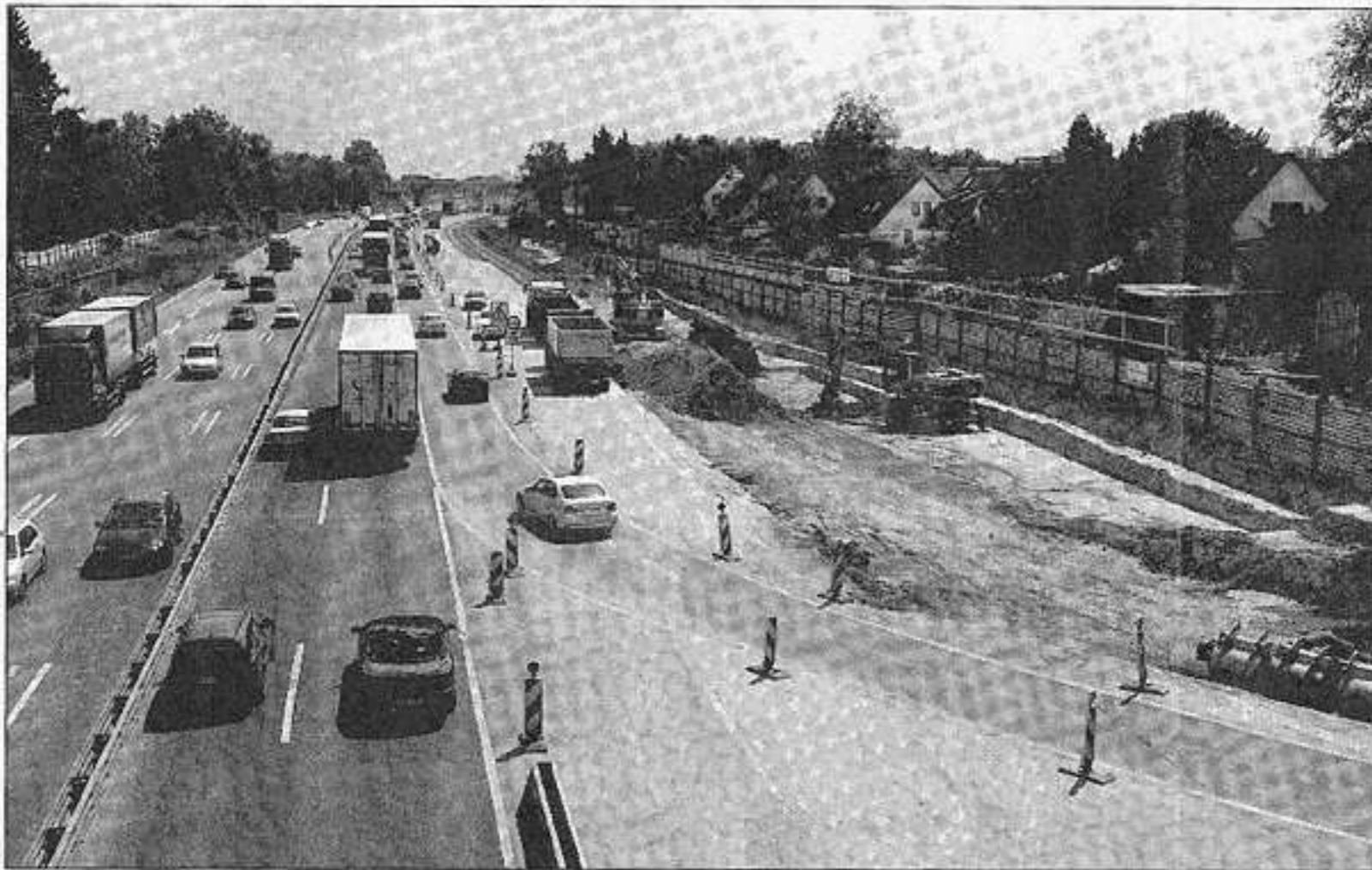
Beim A1-Deckel in Lövenich geben die Straßenbauer Gas, weil Stau wirtschaftlich schadet. (Foto: Gauger)
